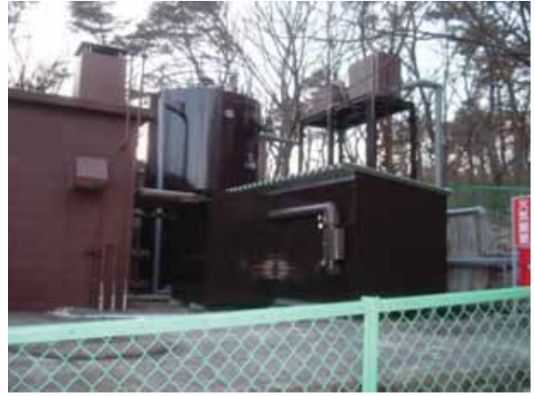
(新那須温泉供給:ヒートポンプ施設)
