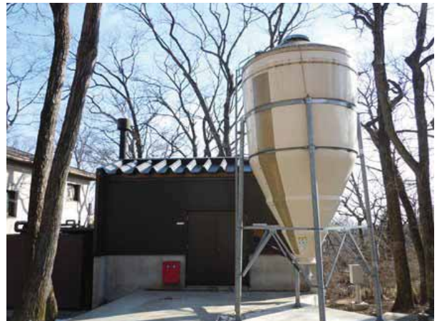
(山水閣:ペレットボイラー施設)
