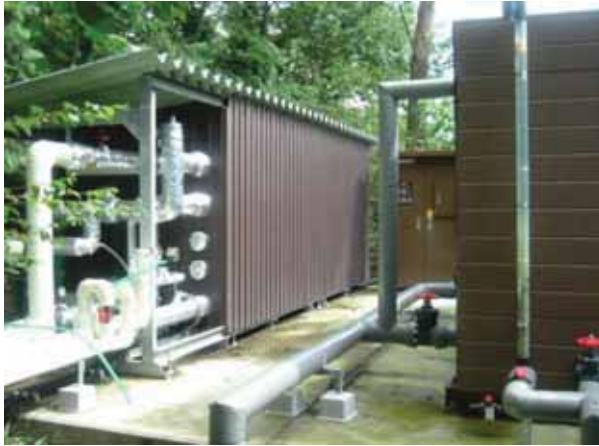
(ホテルサンバレー:ヒートポンプ施設)
