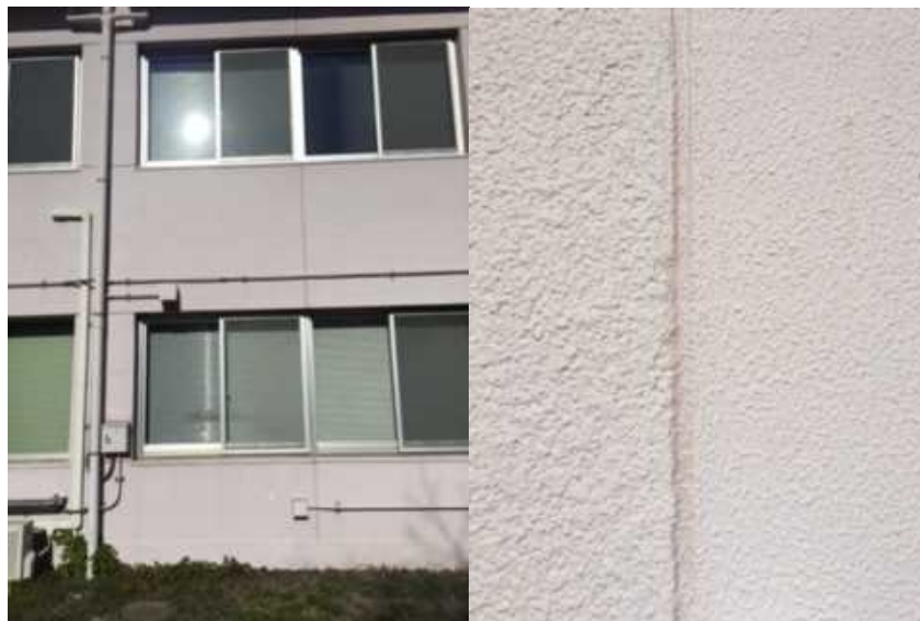
モルタル外壁の事例
