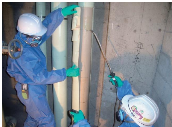
図 4.8.3 保温材の湿潤化→取り外し
