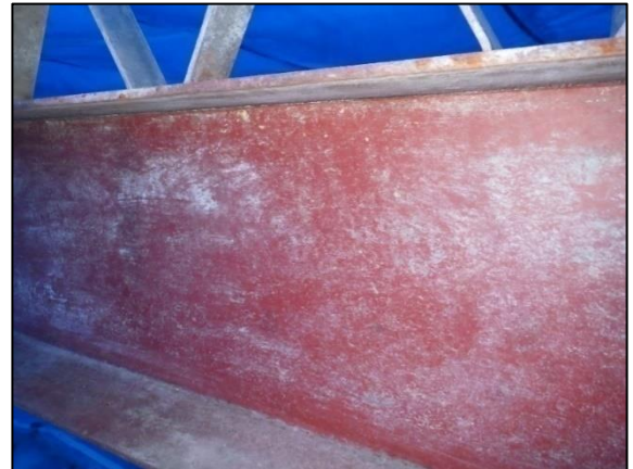
図 4.7.70 再付着した石綿の例
