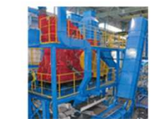
金属破碎・選別設備
