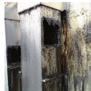
排出口の油汚れ
