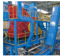
金属破碎・選別設備
