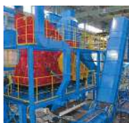
金属破碎・選別設備
