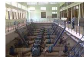
高効率ポンプ（ベトナム）
