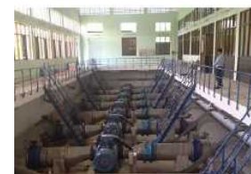
高効率ポンプ（ベトナム）
