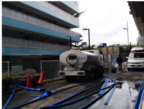
東京都世田谷区（画像：環境省） これまで被災したことのない都市部の市街地にも 浸水被害を及ぼしました
