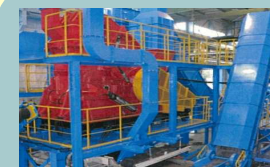
②金属破碎・選別設備
