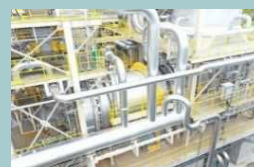
④高効率廃熱回収設備
