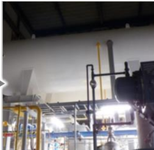
図8 CO2回収設備
