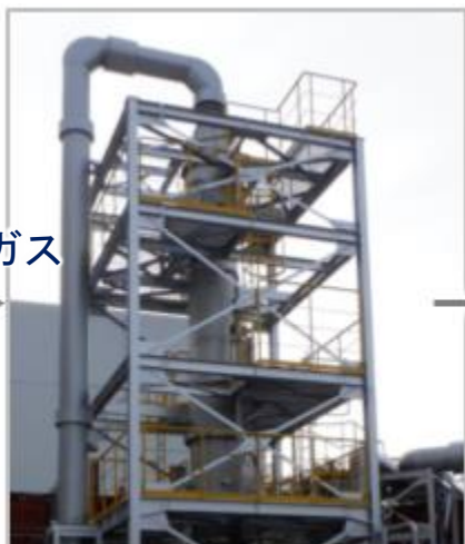
図7 排ガス冷却設備
