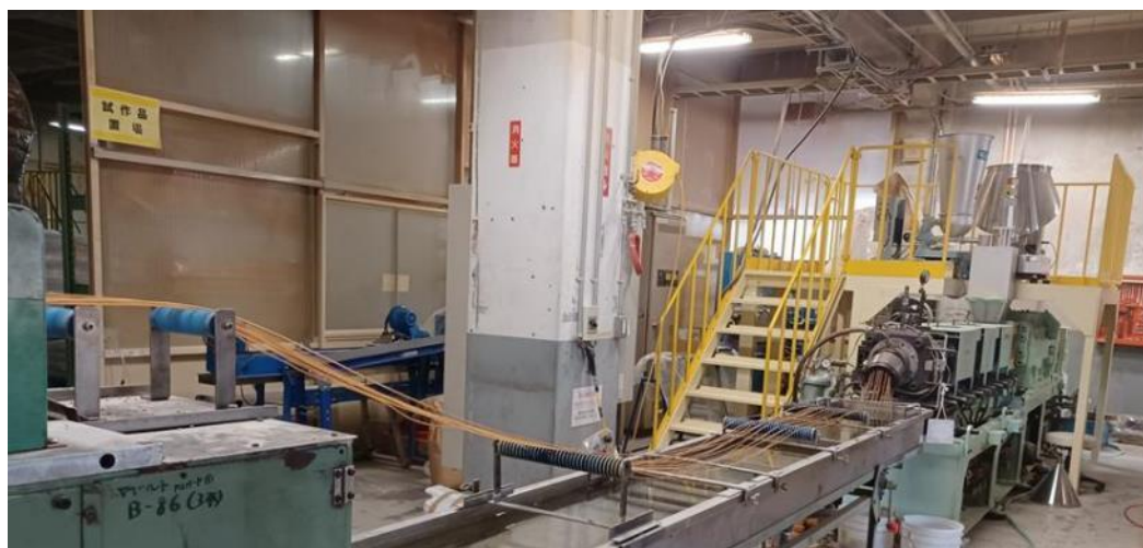
図 2-1-3-1 量産テストに用いたコンパウンド設備
