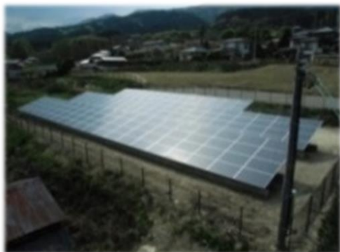
中部電力との協働による管内初のメガソーラー発電所
