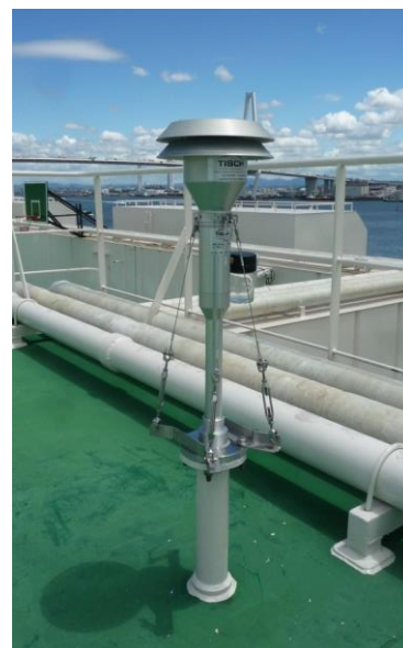
図5. 船舶屋外に設置されたエアロゾル採取インレット
