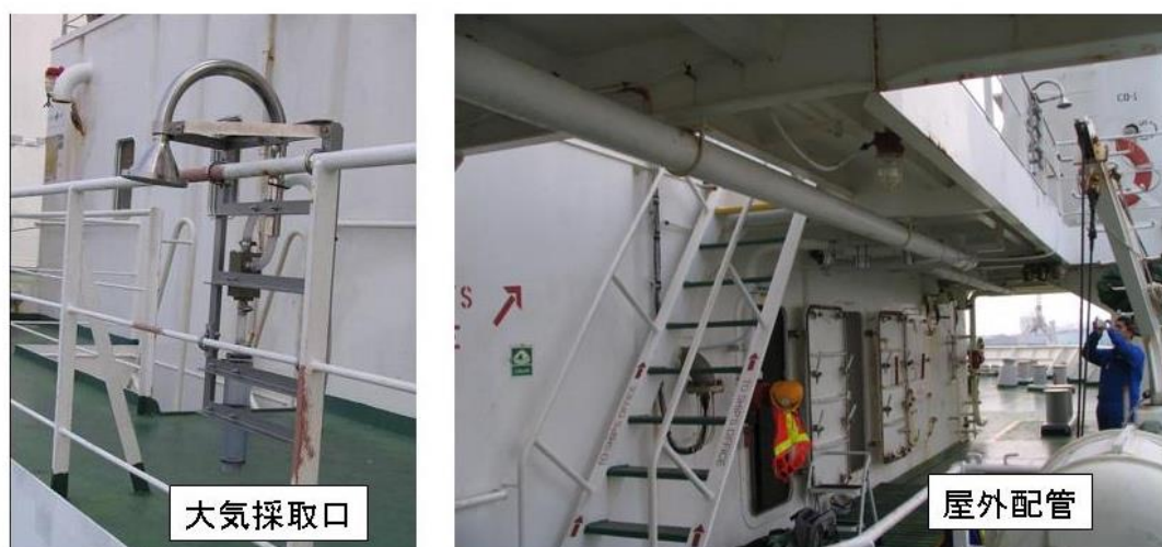
図3. 連続測定器の大気採取口と屋外配管
