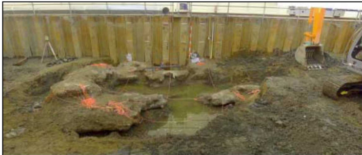
汚染源掘削調査により発見されたコンクリート様の塊（平成 17 年 1 月 27 日）
