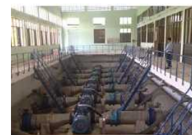
高効率ポンプ （ベトナム）
