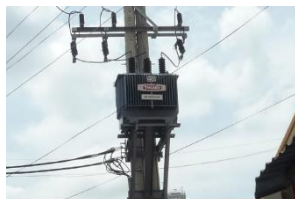
高効率変圧器
