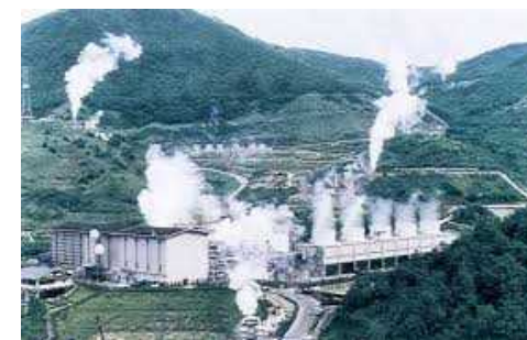
大分県HP引用 地熱発電施設
