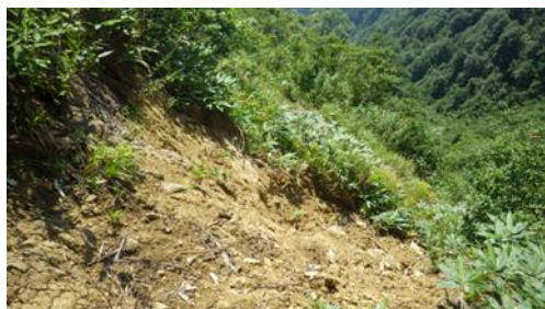
既存登山道（荒廃箇所）
