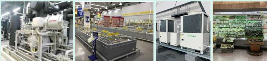
支援事業により導入された自然冷媒機器
