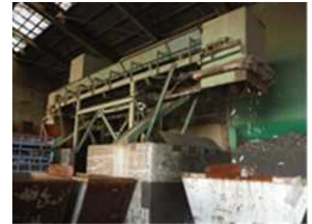
②破碎されたプラスチックを廃プラスチック炭化施設へ搬送
