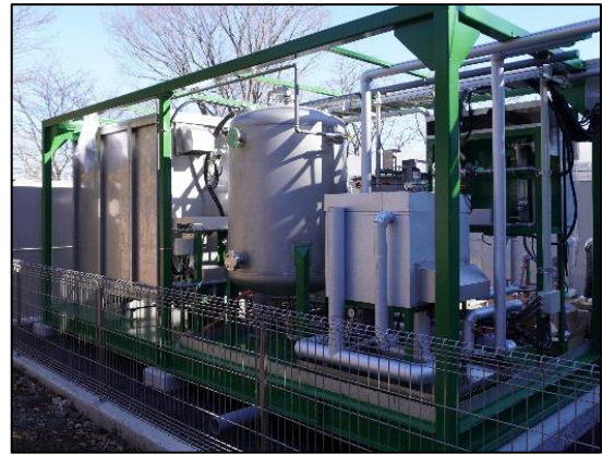
メタン発酵バイオガス発電設備
