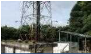
携帯電話基地局へのトライブリッド技術導入（KDDI）
