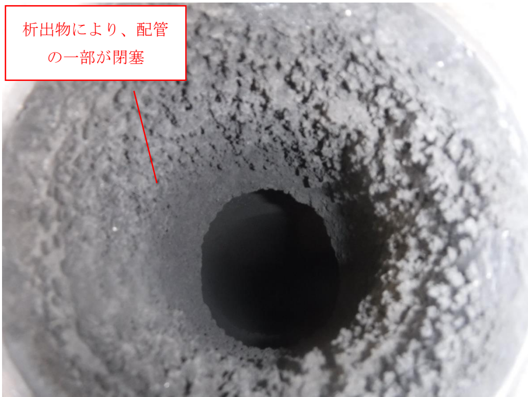
図 5-2-19 入口側エキスパンション上部配管閉塞状況
