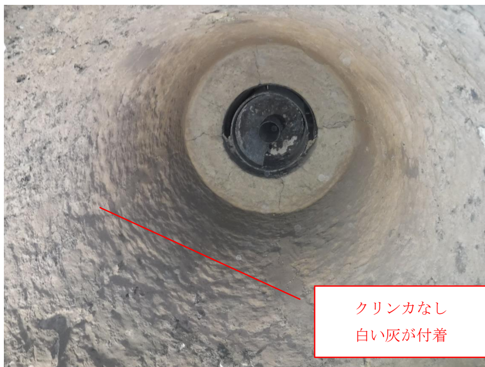
図 5-2-15 漏れ込み空気対策後のクリンカ付着状況
