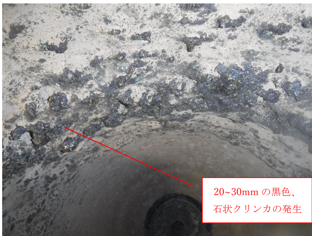
図 5-2-9 チャー混焼開始後のクリンカ付着状況(付着が激しい箇所)
