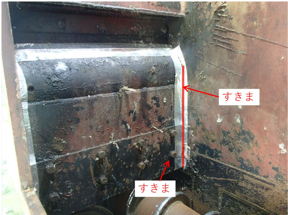
図 5-2-2 ブリッジ解除装置(改造前)
