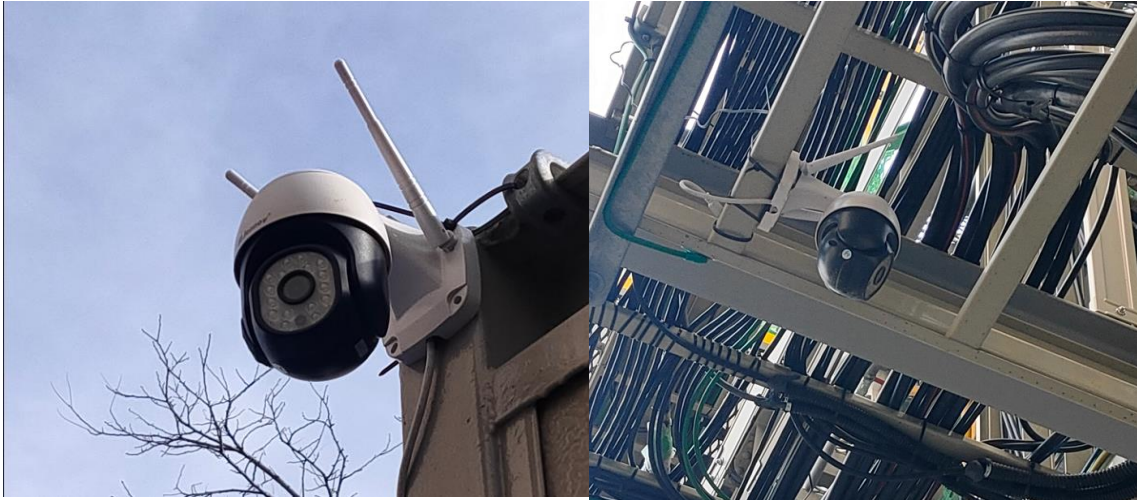
図 5-4-4 Wi-fi カメラの設置状況
