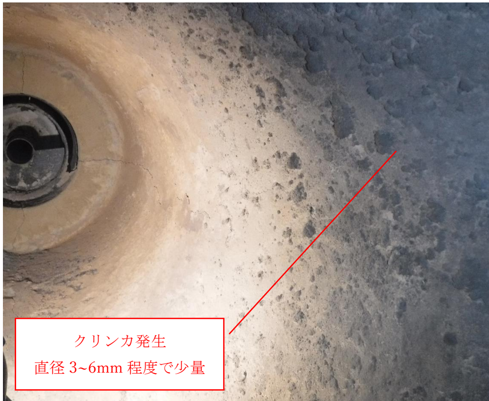
図 5-2-16 漏れ込み空気対策後のクリンカ付着状況(バーナー側)
