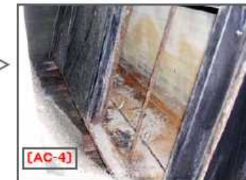
空調機AC-4の内部
