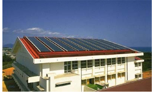
沖縄県うるま市立具志川東中学校 (給湯、プール水加温)
