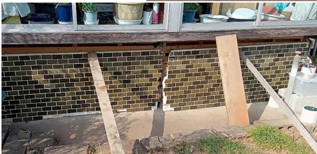
登米市 住宅外壁崩壊 環境省撮影 (令和4年3月25日時点)
