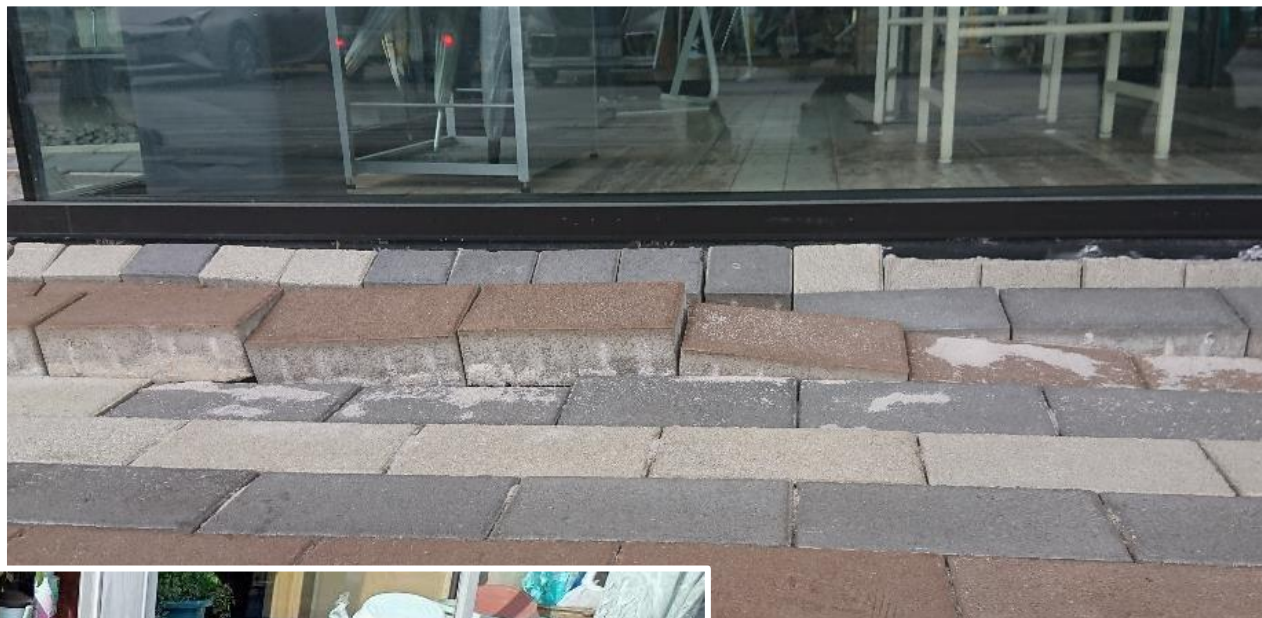
国見町 路面の歪み 環境省撮影 (令和4年3月19日時点)
