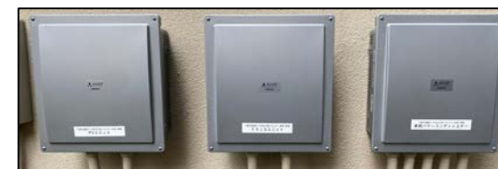
千葉市立千城台西中学校 設置設備
