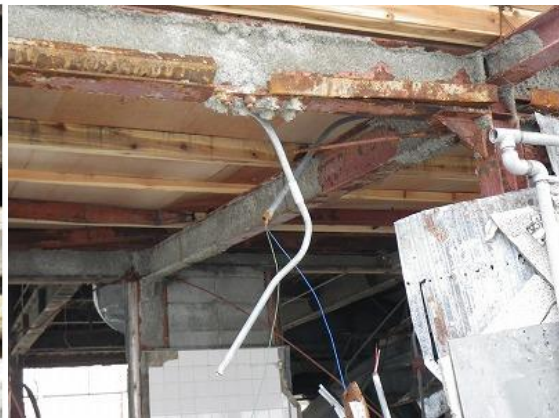
残存した吹付け材
