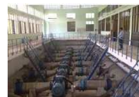
高効率ポンプ （ベトナム）
