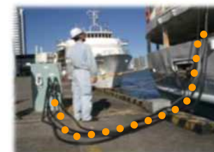
電力供給設備
