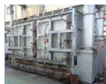
Li-ion電池 リサイクル設備
