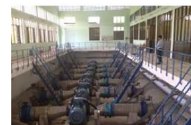
高効率ポンプ （ベトナム）
