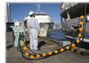
電力供給設備
