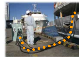
電力供給設備
