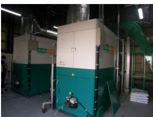
チップボイラー
