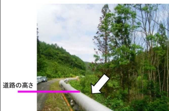
○上の岱地熱発電所
