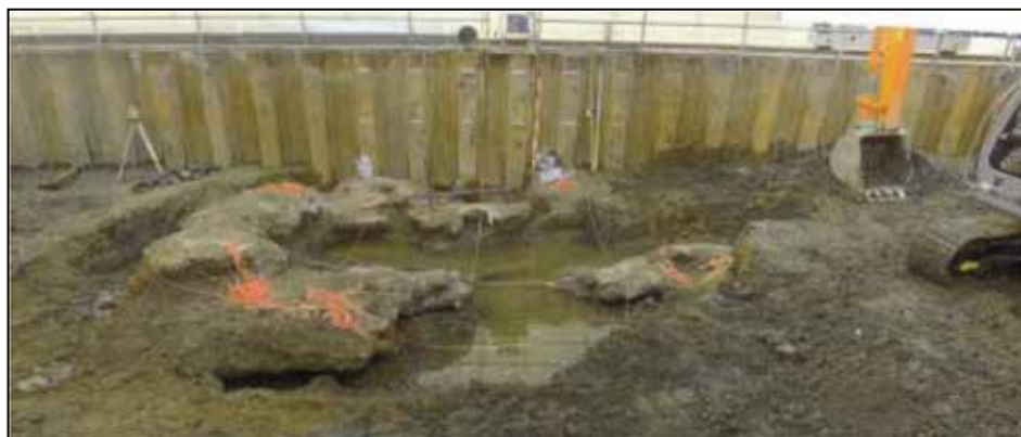
写真 1 汚染源掘削調査により発見されたコンクリート様の塊 （平成 17 年 1 月 27 日撮影）
