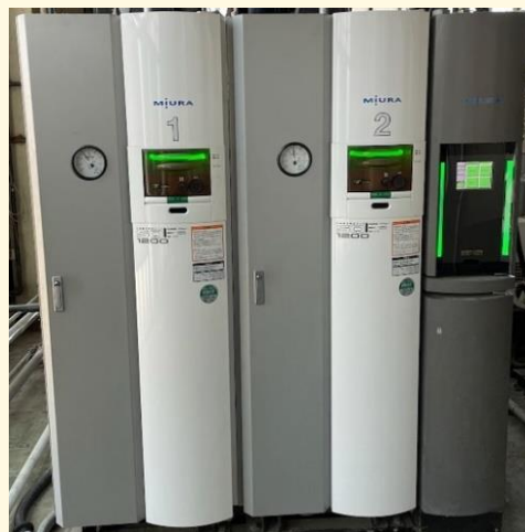
LP ガスボイラー
