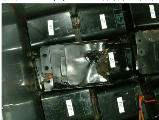
切断された廃安定器の保管例 (2)
