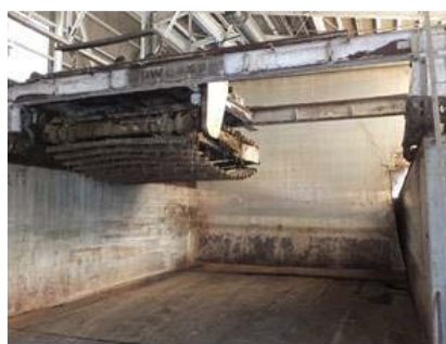
写真6 一次発酵槽の出口側
