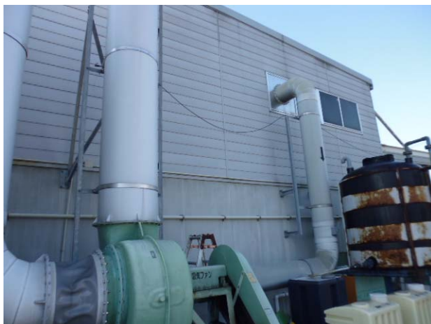
写真6 堆肥棟から排出ガスを吸引（2ヵ所）
