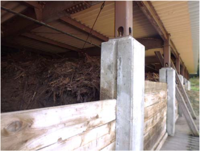
写真6 生物脱臭槽（バーク高さ2.5m）
