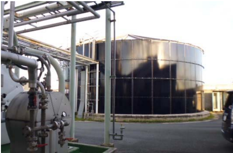
写真 1 液肥の貯留タンク
