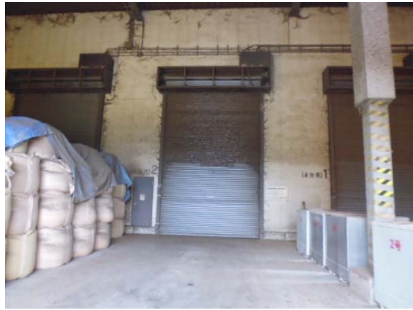
写真6 畜ふん原料投入口
