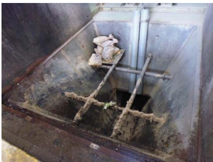
写真 1 原料の投入口
