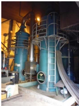
写真5 排ガス処理装置
