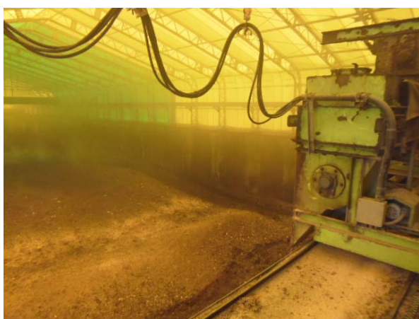
写真1 原料投入機（前半発酵）
