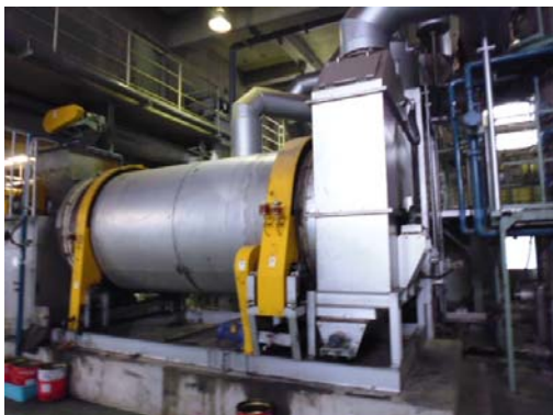
写真 1 汚泥乾燥炉（800℃で熱風乾燥）
