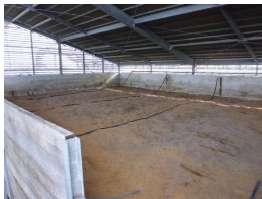
写真6 生物脱臭槽で脱臭処理
