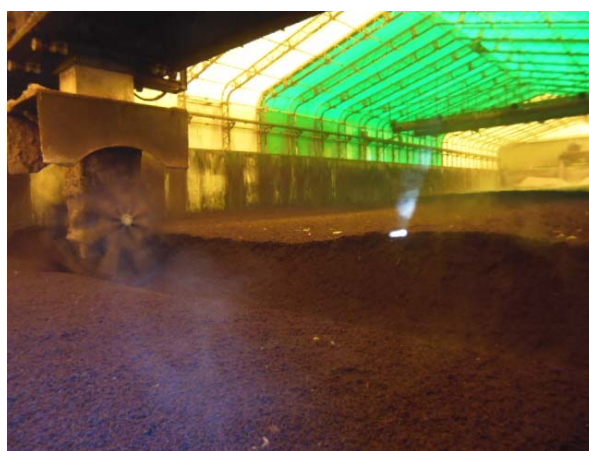
写真2 パドル式攪拌機（後半発酵）
