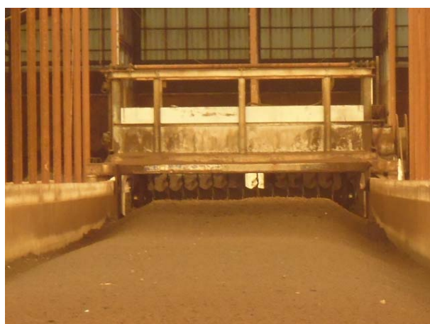
写真5 攪拌機（二次発酵槽）
