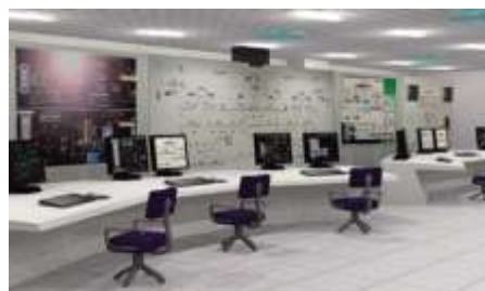
制御システム
