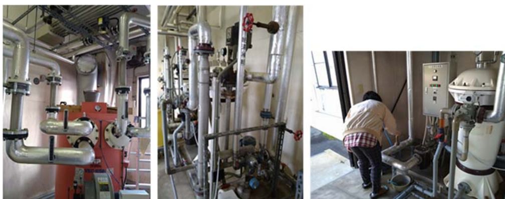
写真 3-2-4 ボイラー室(左)、熱交換器(中)、ろ過装置(右)
