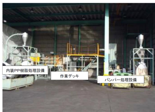
図 2-24 内装 PP 樹脂・バンパー処理設備設置状況
