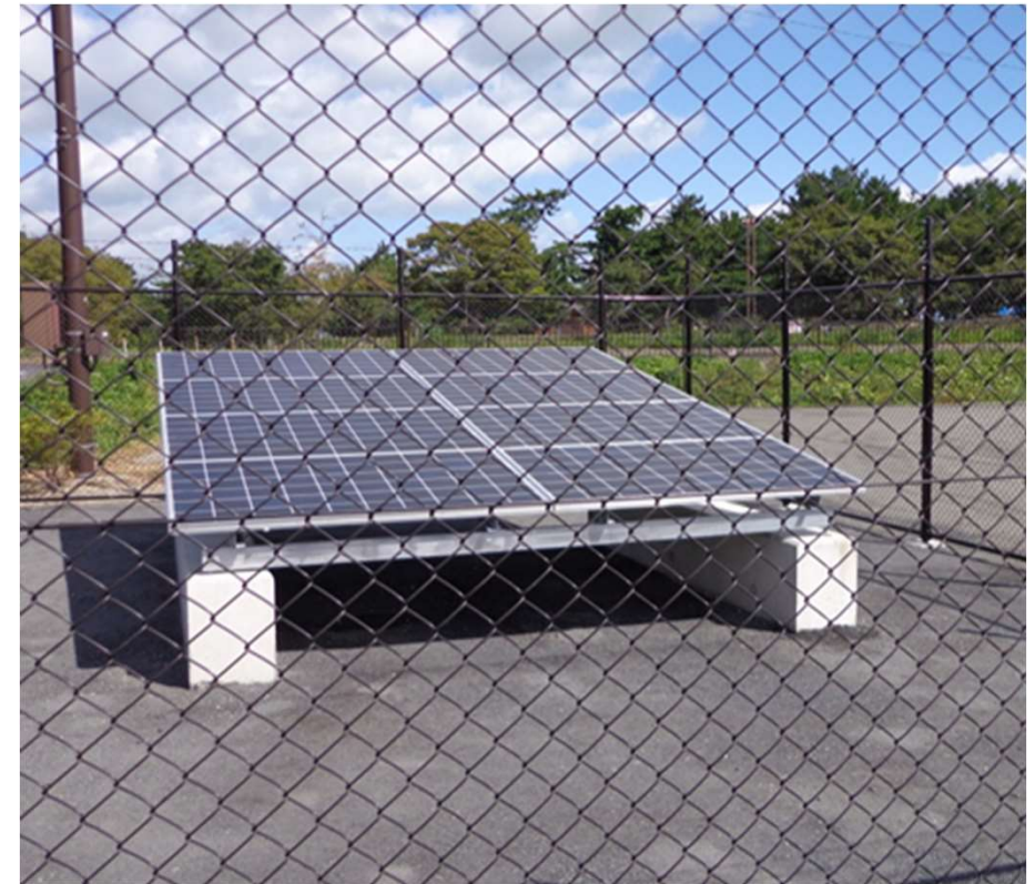
非常用太陽光パネル
