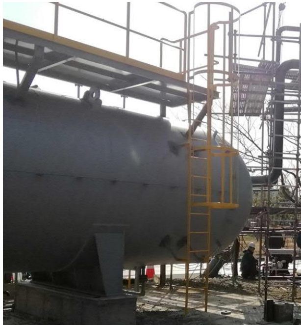
図 4.2-3 蔚山工業団地の蒸気供給に利用されている蒸気アキュムレータ
