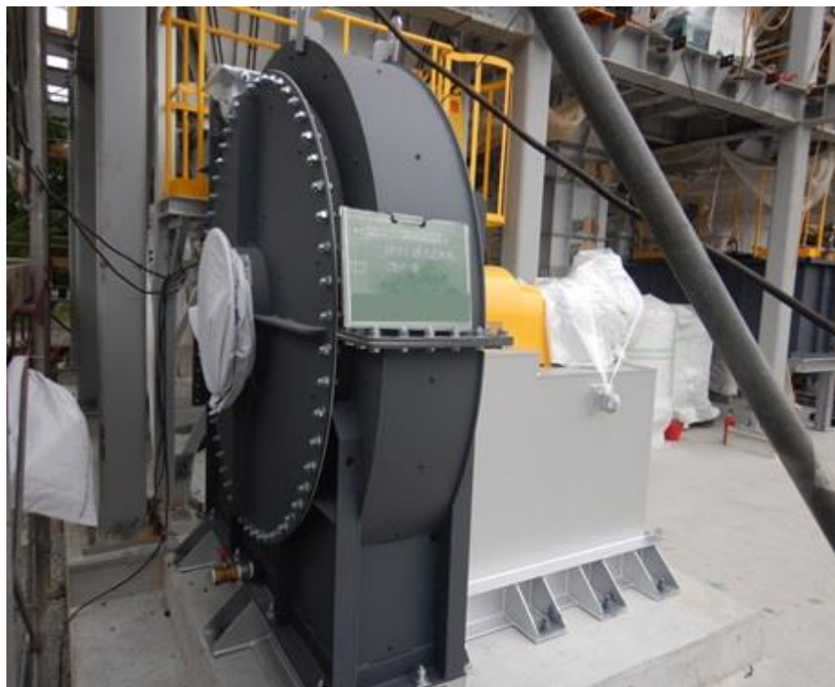
図 5-4-13 排ガス誘引送風機
