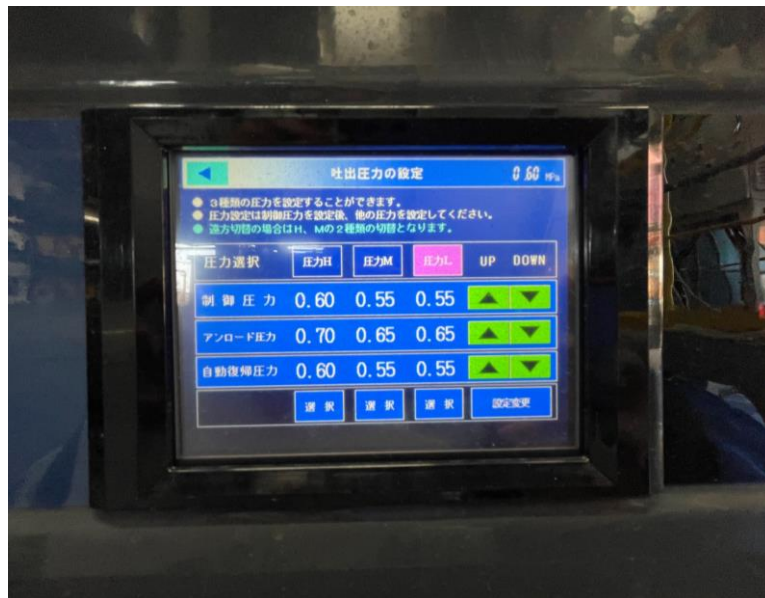
図 5-8-4 空気圧縮機の圧力警報の設定画面
