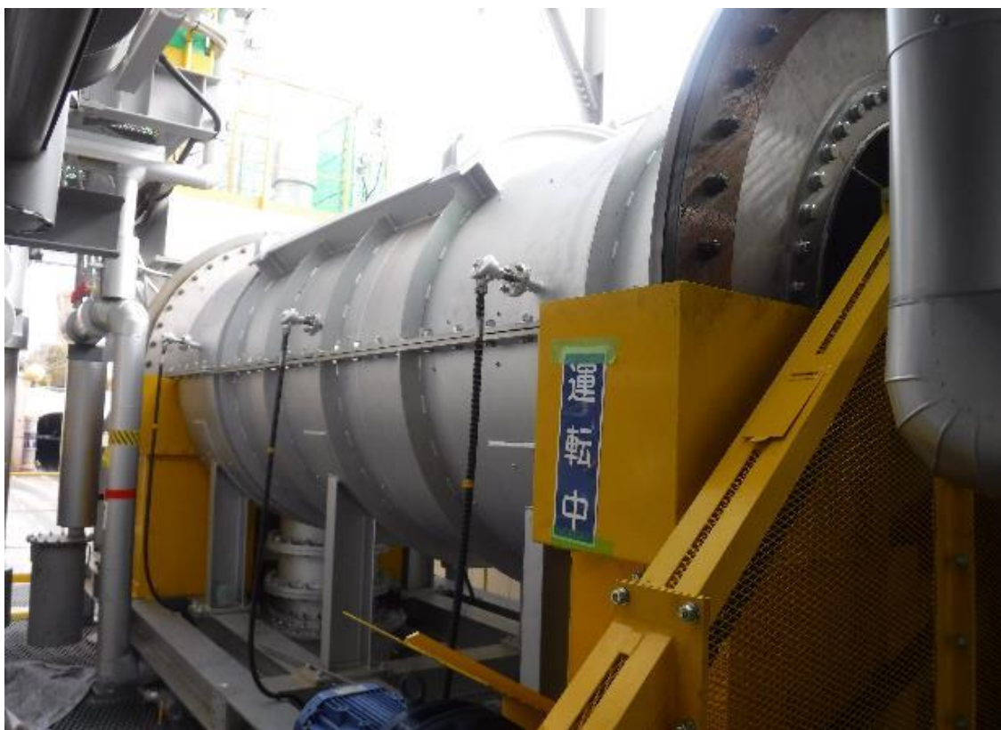
図 5-6-6 運転時の熱分解ガス化改質炉の状況
