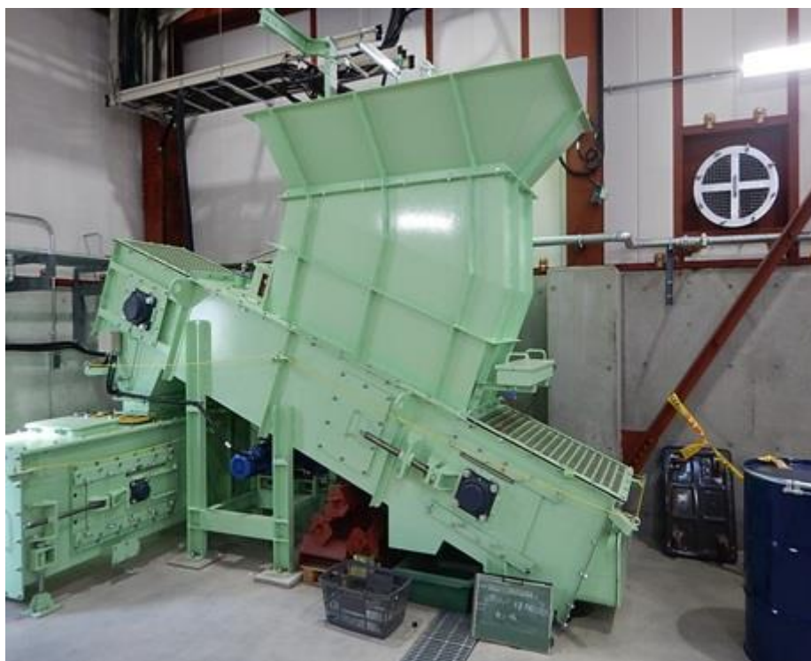
図 5-4-4 投入ホッパ・定量供給コンベヤ
