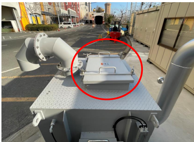
図 5-8-9 脱臭装置の点検口の設置状況
