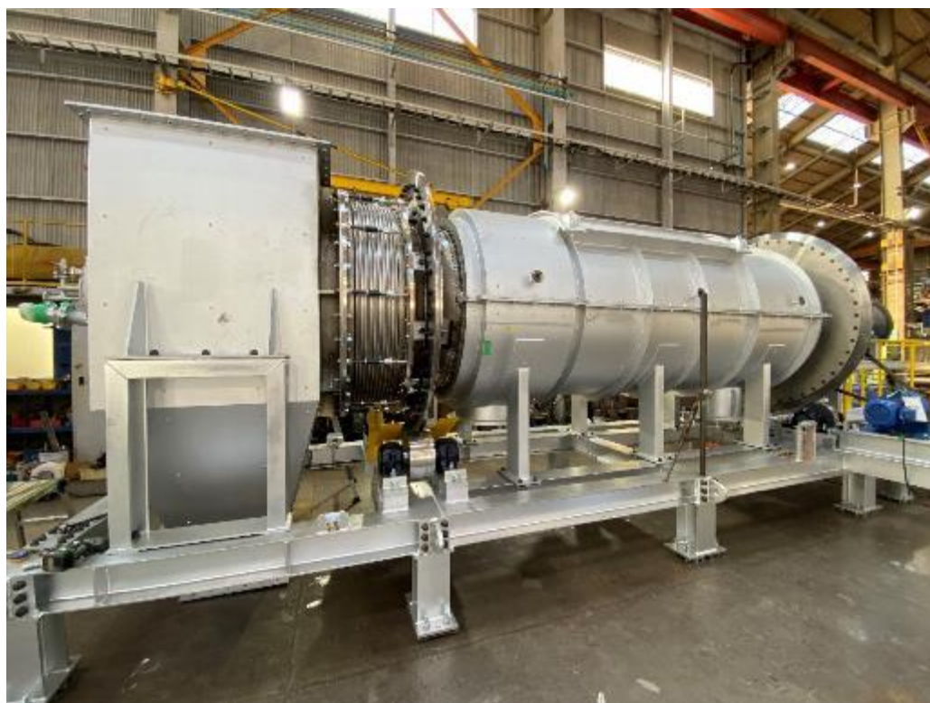
図 3-3-7 熱分解ガス化改質炉全体
