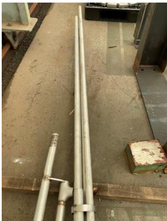
図 3-3-4 熱分解ガス化炉改質炉の接続管
