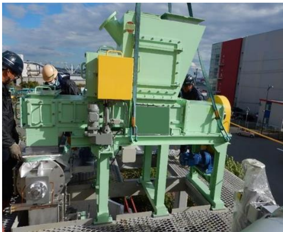
図 5-3-4 給じん装置の納入時の状況
