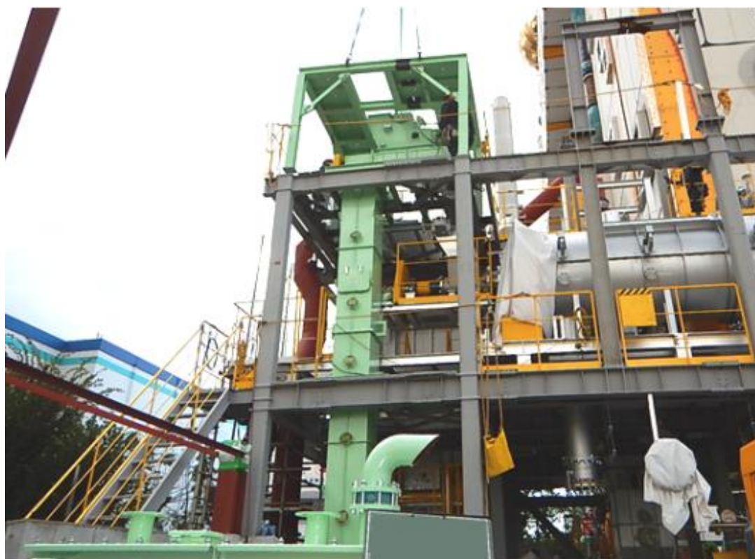
図 5-4-5 破碎ごみ供給コンベヤ
