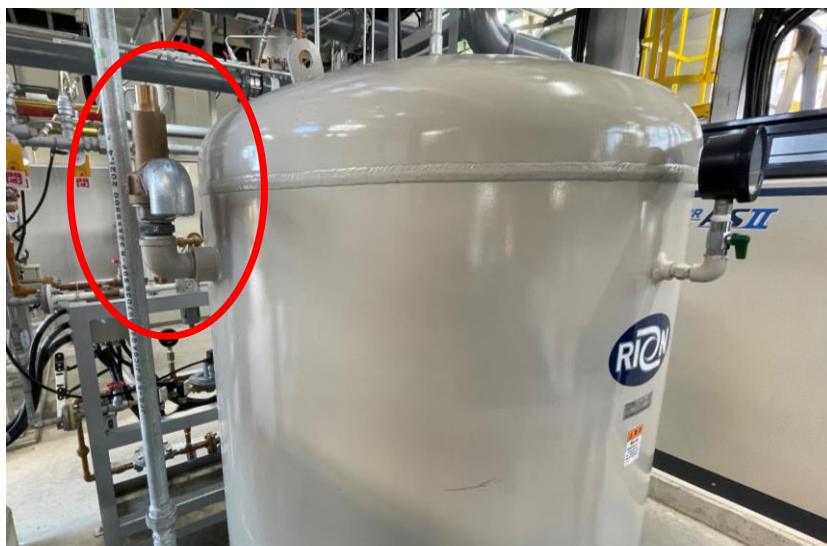
図 5-8-6 圧縮空気タンクの安全弁設置状況
