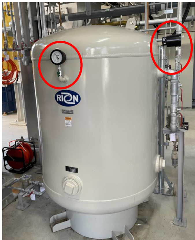
図 5-8-3 圧縮空気タンクの圧力計設置状況
