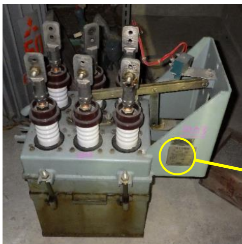
遮断器 (油入遮断器)
